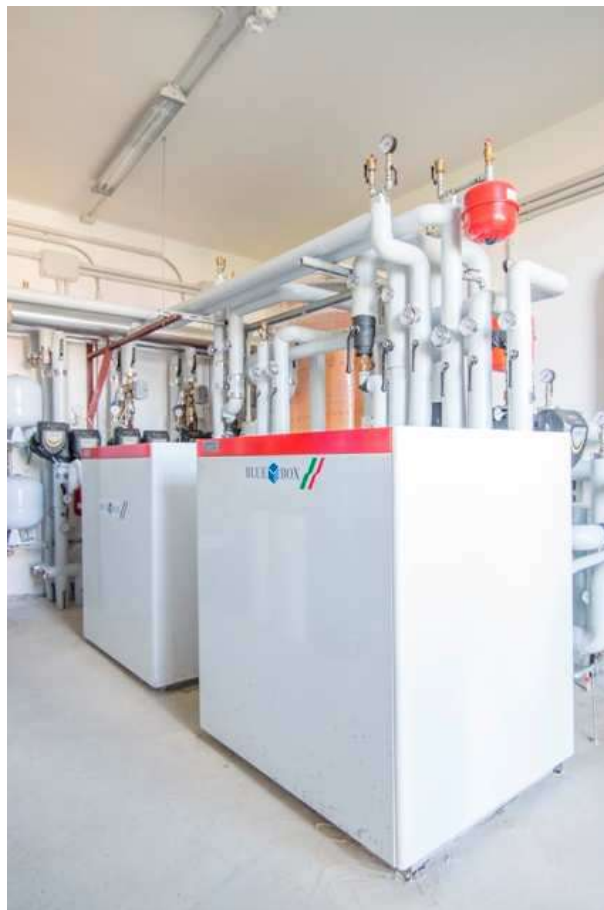
La sala con gli impianti di geotermia
