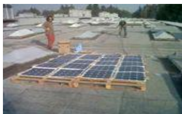
Figura 28 – Esempio di pannello fotovoltaico
